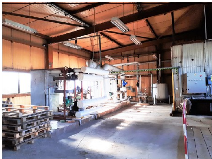
Rysunek 3. Widok pomieszczenia wymiennikowni.
